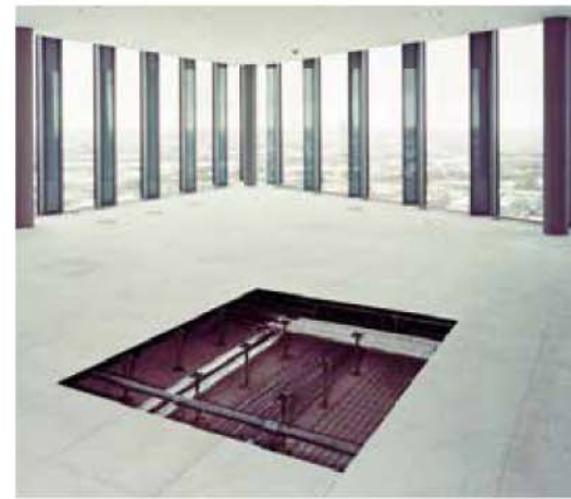
Ανοικτά στοιχεία σε υπερυψωμένα δαπέδα εξασφαλίζουν άνετη πρόσβαση σε εγκαταστάσεις
