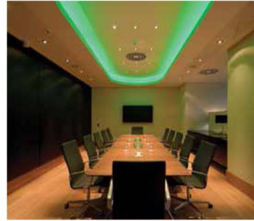
Η εγκατάσταση του φωτισμού LED γίνεται σε εσοχές σχήματος U στην οροφή π.χ. σε αίθουσες συνεδριάσεων
