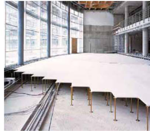
Υπερυψωμένο δάπεδο GIFAfloor FHB plus με σπρίγματα και διπλή στρώση πλακών και τοποθέτηση εγκαταστάσεων στο διάκενο
